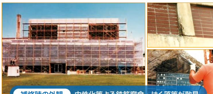
補修時の外観 中性化等による鉄筋腐食・はく落等が散見
